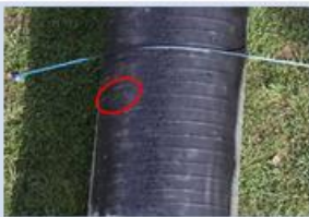
Conduite Forcée (ligne de rouille)
