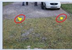
Clôture en grillage (trous)
